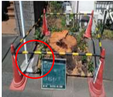
図2 舗装・縁石の隆起
